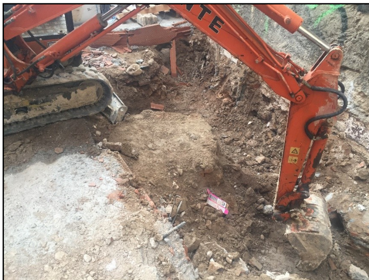
Fig. 13. Àrea de la zona d'obertura del forat d'ascensor (rasa 6), assolint el nivell d'1 m des del nivell de circulació actual.
