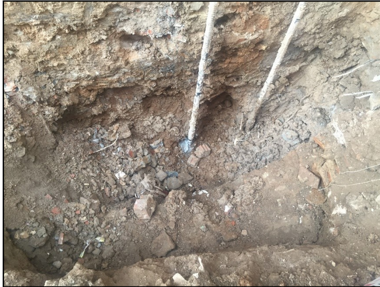
Fig. 12. Zona de màxima profunditat de la rasa 5 i rasa 6. S'intueix el final de la fonamentació de l'edifici carrer Sant Pau, 88 i el nivell d'argiles netes (UE 6).
